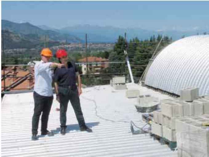
Il sindaco di Rosta sul tetto della scuola Colloidi durante i lavori
