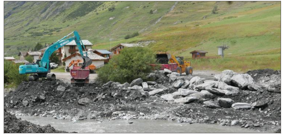
« La priorité est de permettre le retour de l'Arc dans son lit et de dégager le cône de déjection du ruisseau du Claret », explique Christophe Lombard. Ici, l'engin de Bonneval-sur-Arc venu en renfort, et les pelles et camions des entreprises de BTP de la vallée. Photo Le DU/M.G.
